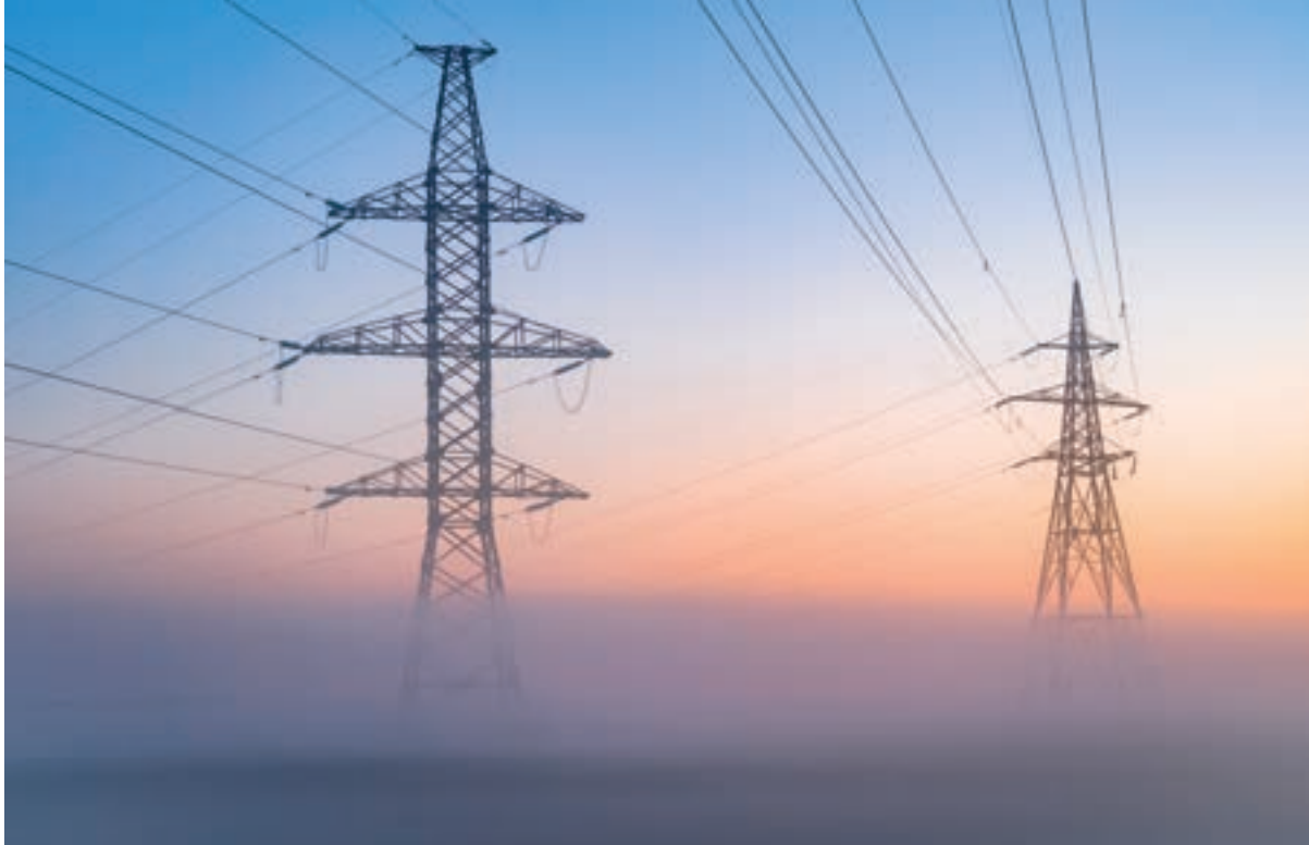
Транмиссионные вышки ЛЭП
