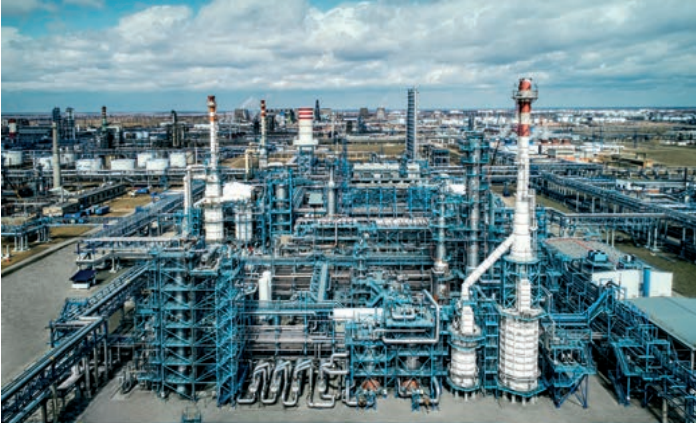
Омский НПЗ, установка по производству водорода
