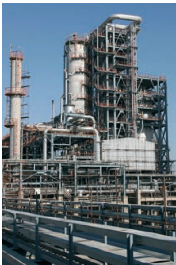
Установка по производству метанола на НПЗ NIOPDC в Иране
