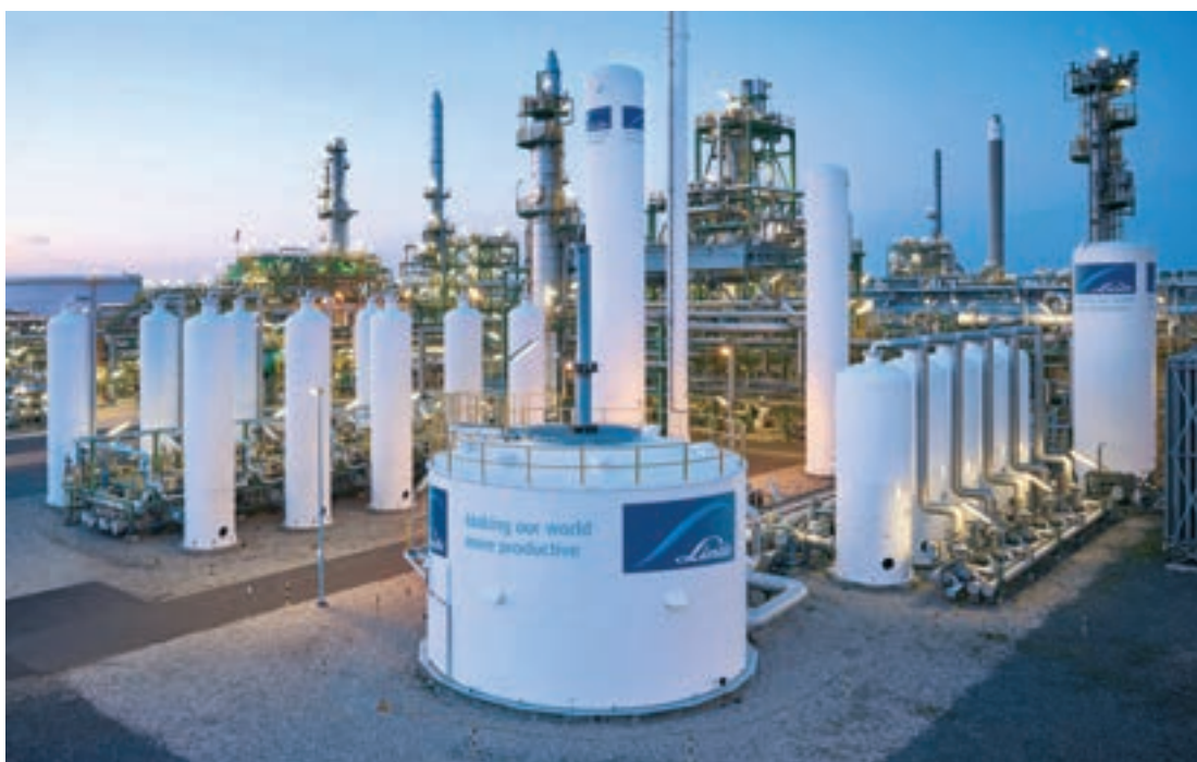
Комплекс Linde по производству и сжижению водорода в Лойне (Германия)
