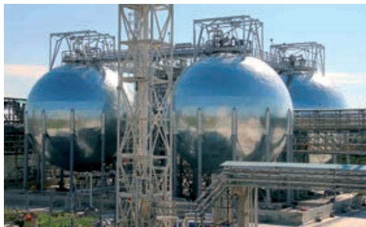
Резервуары для жидкого аммиака, «Щекиноазот» в Тульской области Источник: schekino.su
