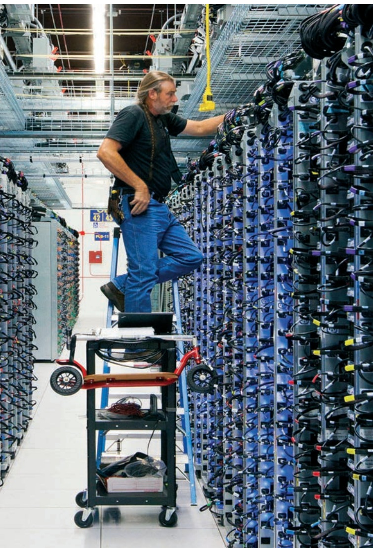
Серверное оборудование в дата-центре Источник: businessinsider.com
