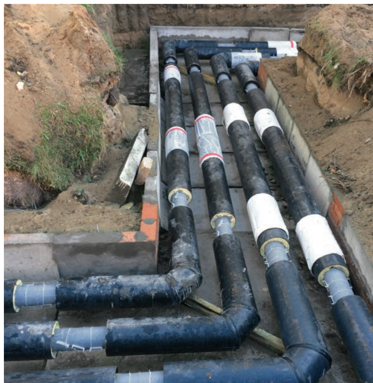
Теплотрасса в Тюмени Источник: 72stroi.ru
