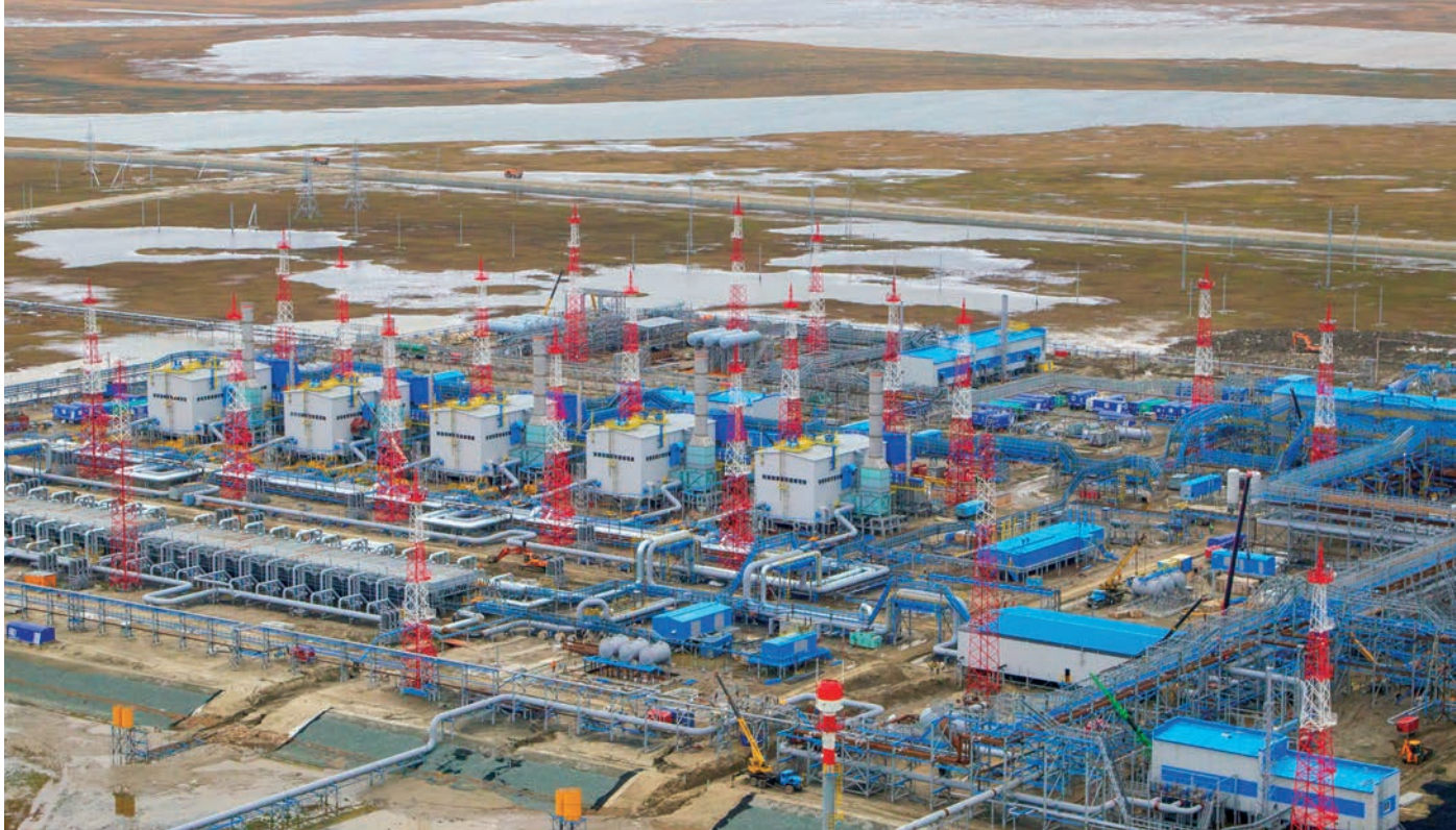
Газовый промысел № 3 Бованенковского месторождения
