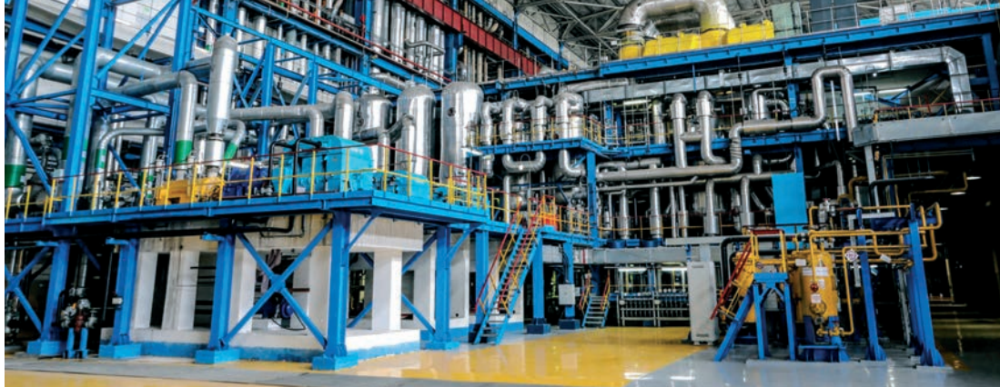
Оборудование Красноярской ТЭЦ
