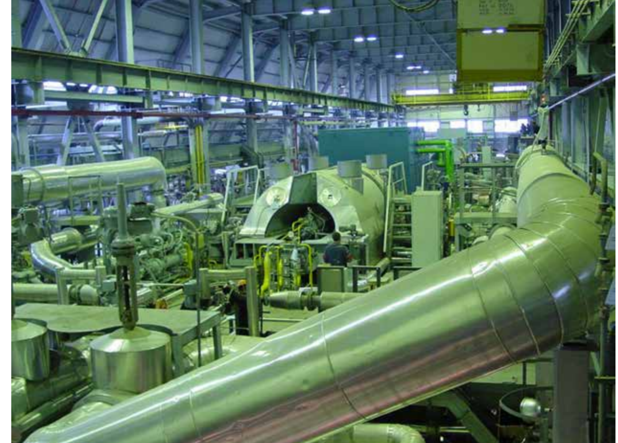
Рис. 3. Машинный зал с турбинами мощностью 25 МВт МГеоЭС-1
