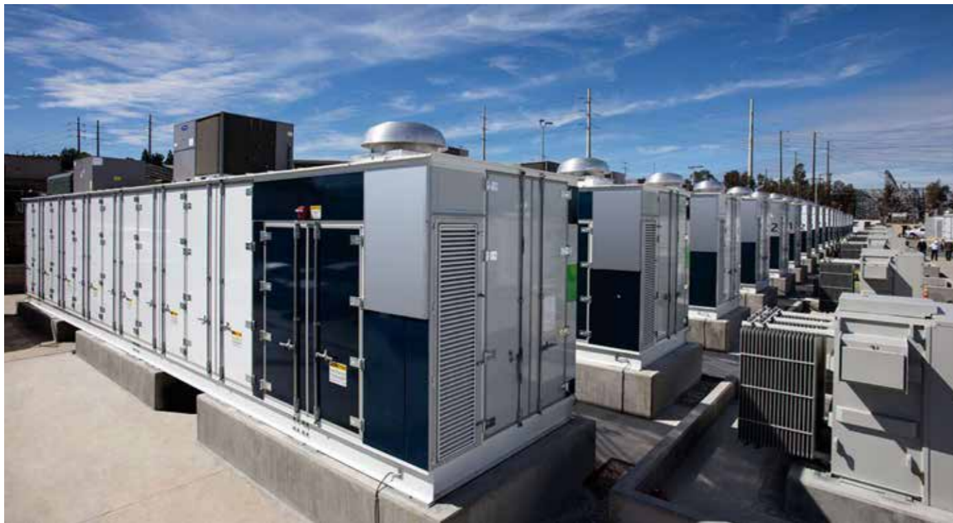
Система хранения энергии
