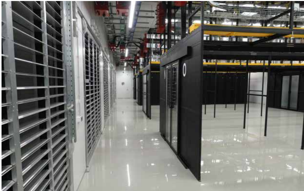
Дата-центр в Новосибирской области
