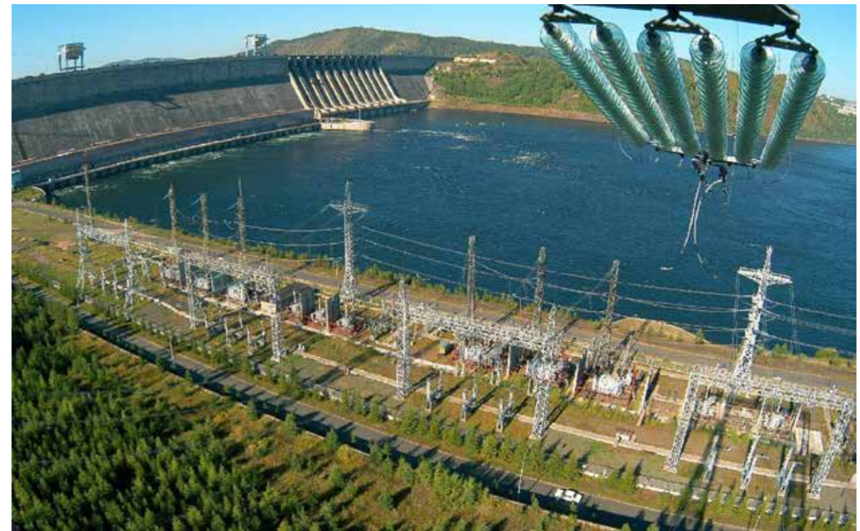
ЛЭП 500 кВ, ГЭС в Усть-Илимске
