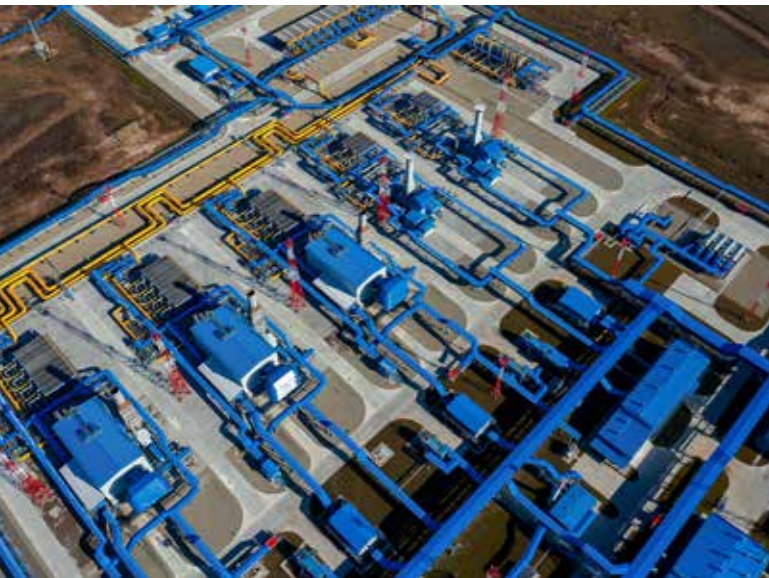
Магистральный газопровод «Сила Сибири на КС «Атаманская» Источник: «Газпром»
