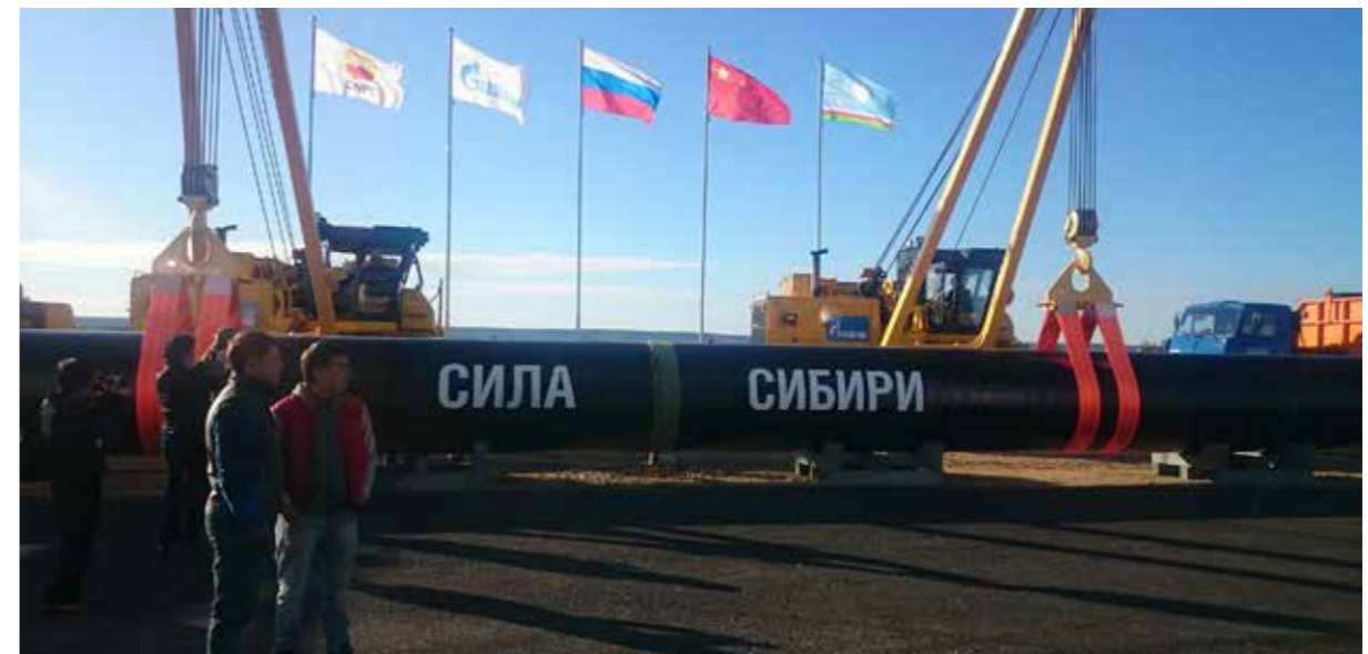
Магистральный газопровод «Сила Сибири»
