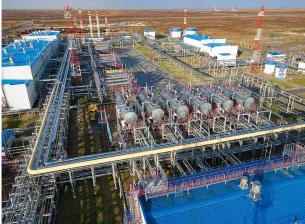
Установка КПГ22. Ачимовские залежи Уренгойского месторождения
